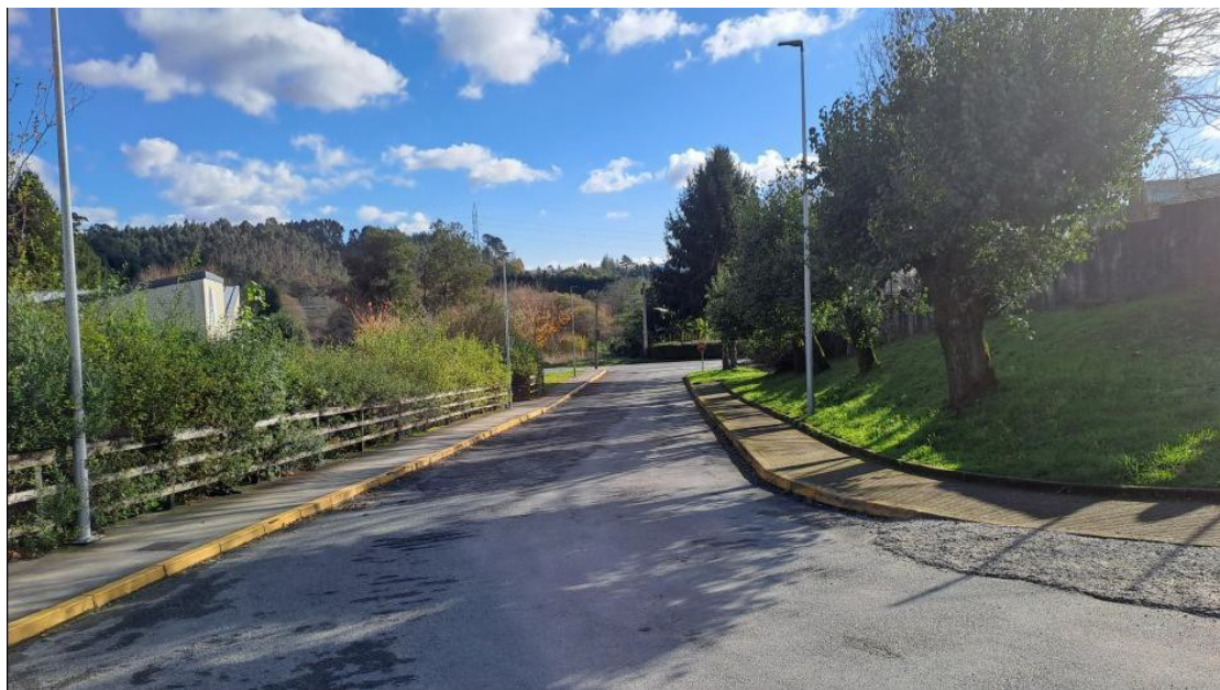
Pavimentos deteriorados e beirarrúas estreitas
